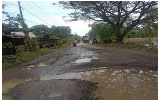
Gambar 11. Kondisi kerusakan jalan sebelum rehabilitasi
