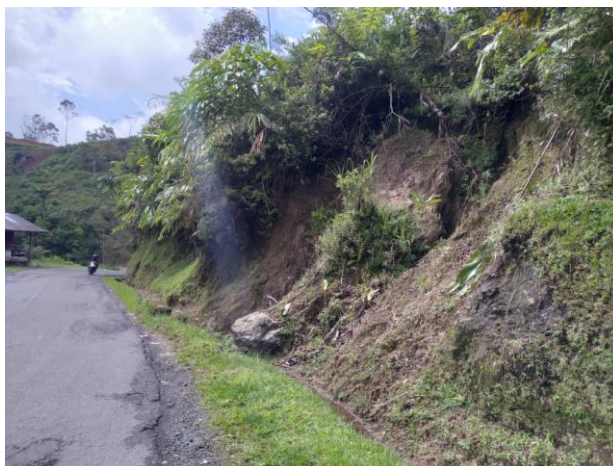
Gambar 8: Kondisi Jalan Rawan Longsor Jalan Raya Cikajang-Pameungpeuk Sumber : Dokumentasi pengamatan.
