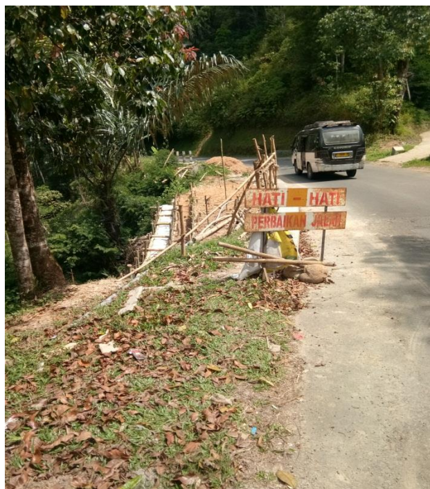
Gambar 7: Kondisi Jalan Rawan Longsor
